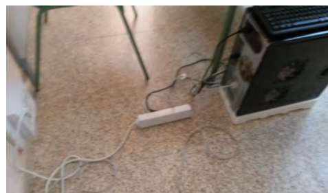
FOTO: Conexiones intermedias. Cableado zona de paso.
