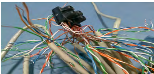
FOTO: Cables desnudos
