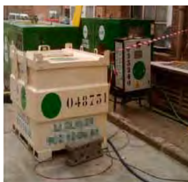
Figura 6. Generador eléctrico de emergencia
