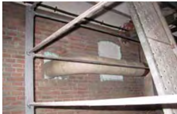
Figura 5. Identificación de posibles entradas de aire.
